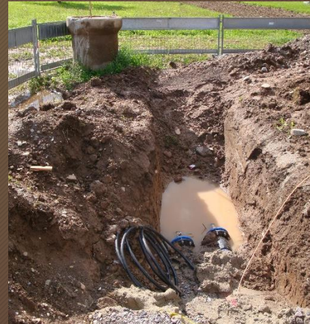
Die Netzanschlüsse für den Eisspeicher
